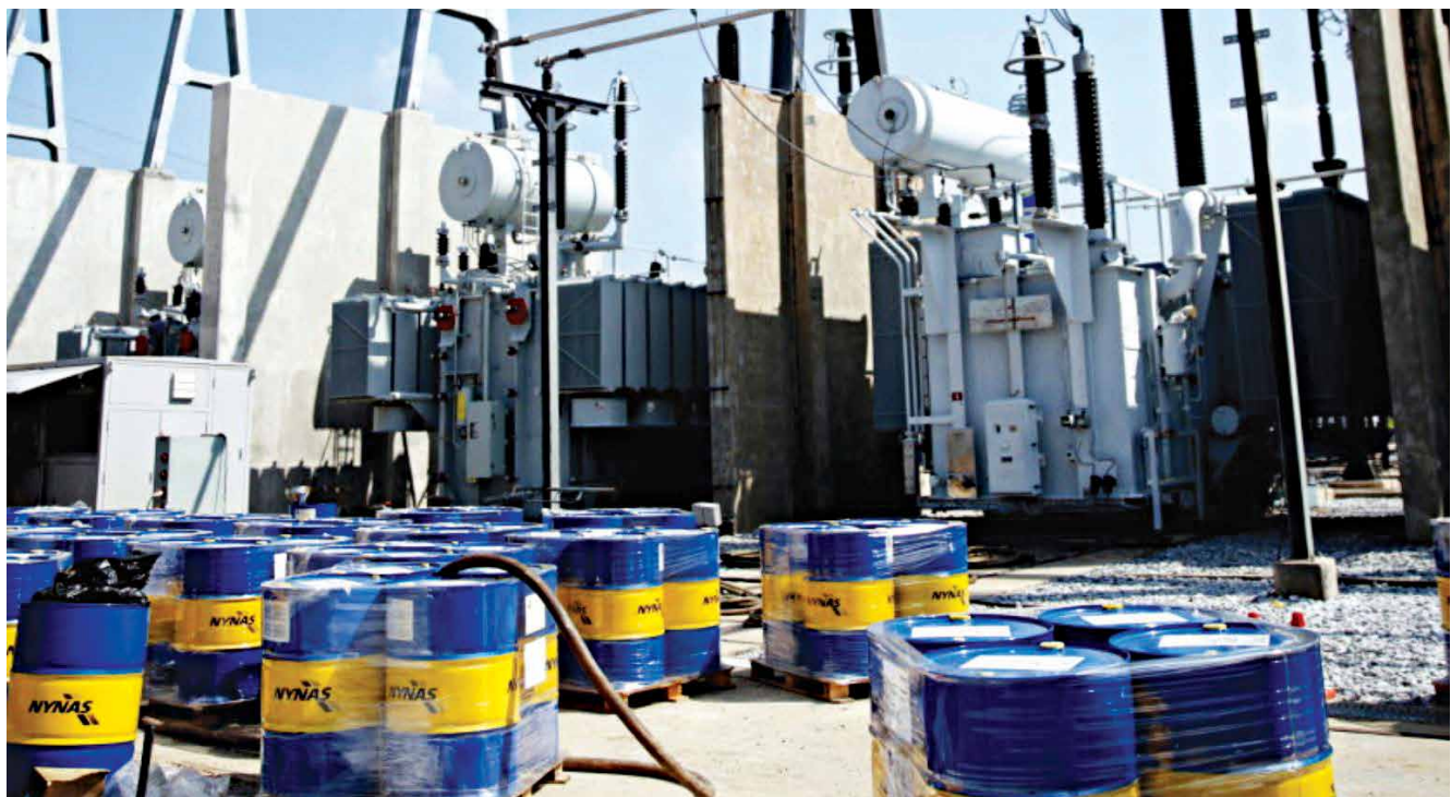
รูปที่ 1 แสดงหม้อแปลงระดับแรงดัน 500kV/230kV เตรียมติดตั้งเพื่อเติมน้ำมันหม้อแปลงชนิดแร่ (Mineral oil)
