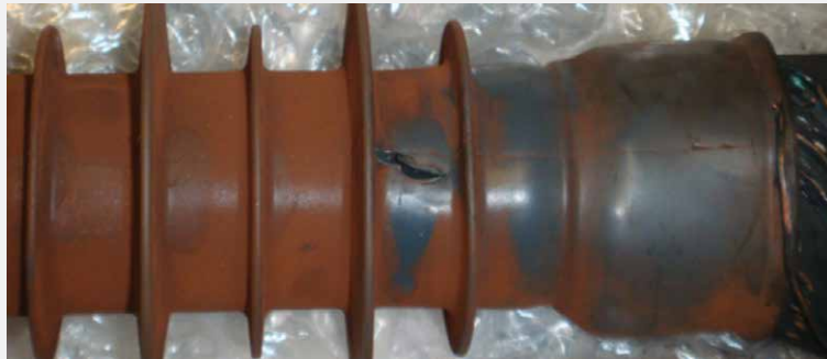
รูปที่ 9 แสดงสภาพการเกิดรอยบนผิว (Tracking)
