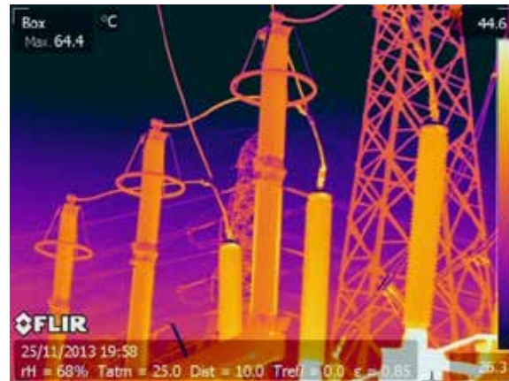
รูปที่ 3 แสดงการตรวจสอบค่าความร้อนที่ Surge Arrestor
