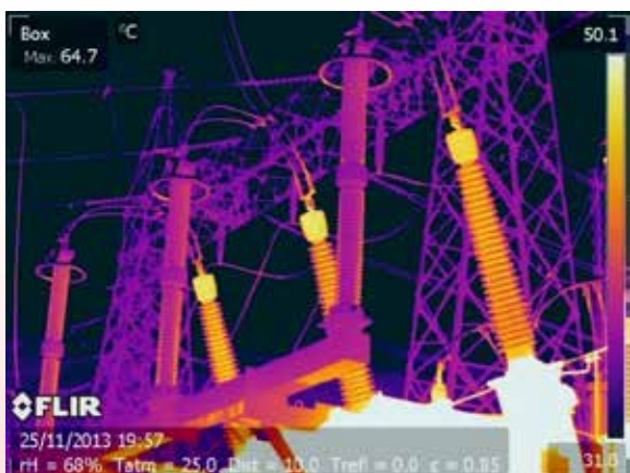
รูปที่ 2 แสดงการตรวจสอบค่าความร้อนที่ Bushing, Rod, Porcelain
