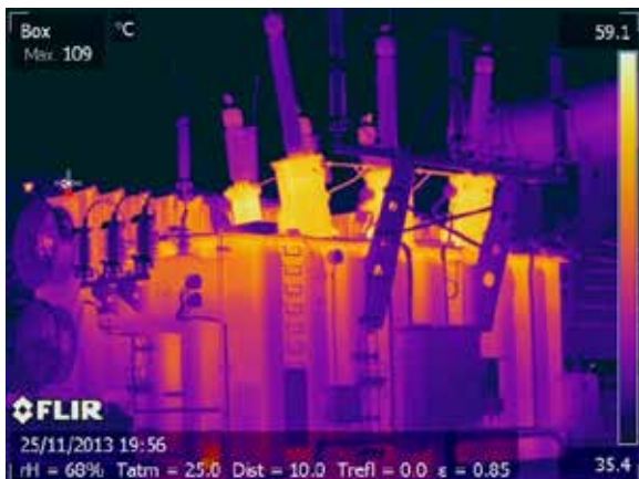
รูปที่ 1 แสดงการตรวจสอบค่าความร้อนที่จุดต่อสาย ด้าน High Side, Low Side, Tertiary Side
