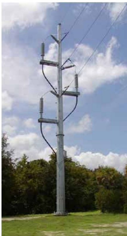
รูปที่ 8 โครงสร้างของการเปลี่ยนผ่านจากสายส่งใต้ดินสู่อากาศขนาดแรงดัน 138 kV
