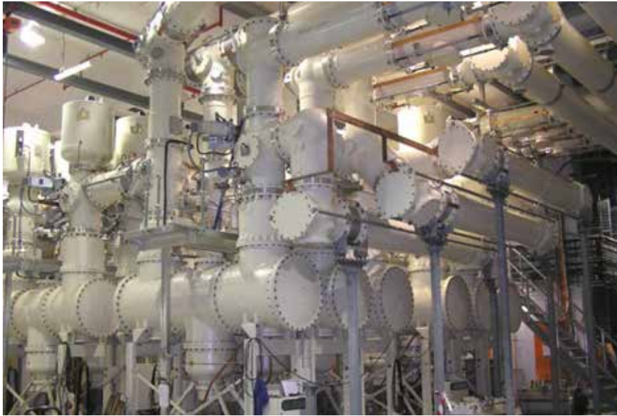
รูปที่ 4 Gas Insulation Switchgear
