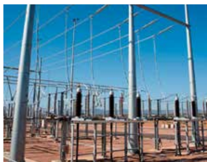
รูปที่ 10 แสดงตัวอย่างสถานีเปลี่ยนระบบไฟฟ้าขนาดเล็ก
