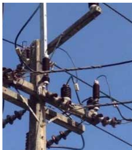
รูปที่ 1 การใช้งานฉนวนลูกถ้วย(อุปกรณ์ ไฟฟ้าแรงสูง) บริเวณกลางแจ้ง
