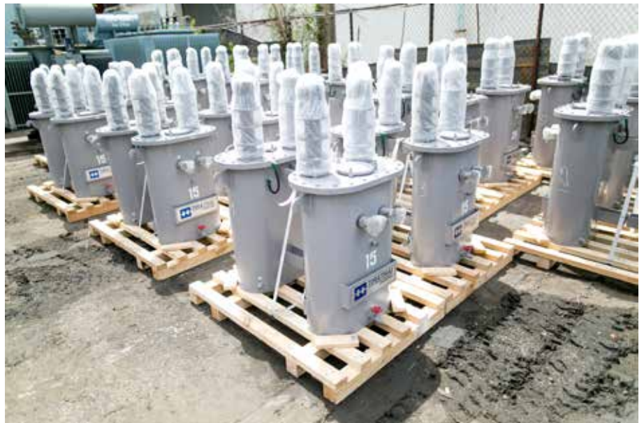
ภาพหม้อแปลงจำหน่าย (Distribution Transformer)
