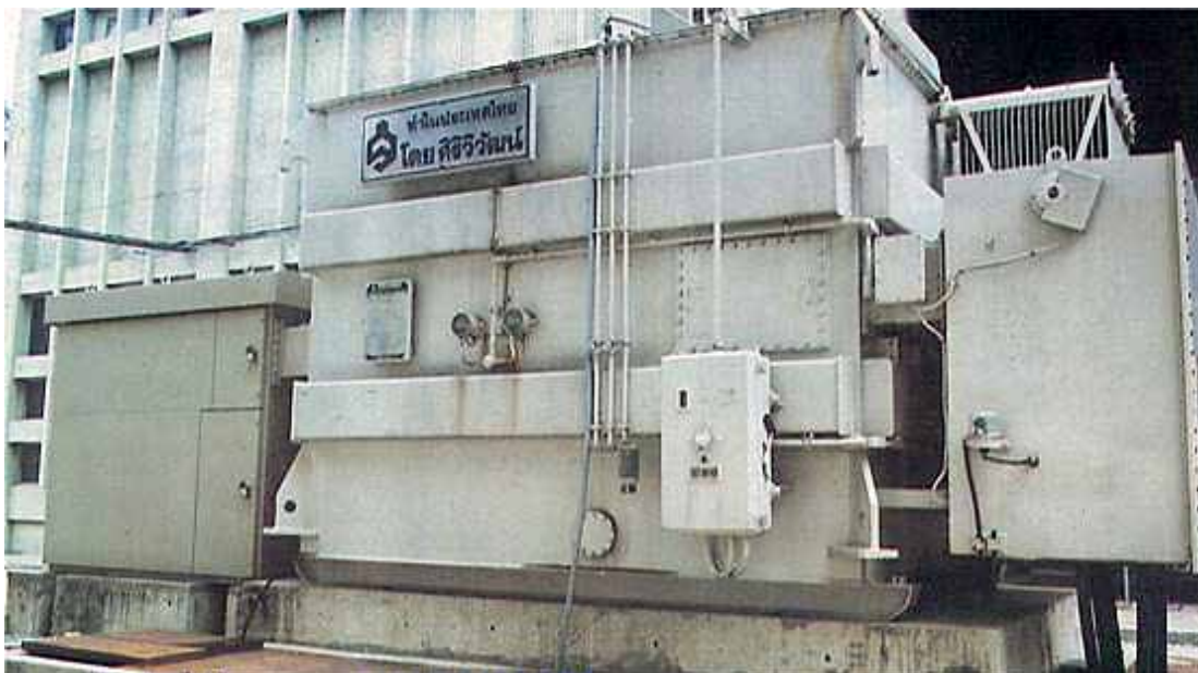
หม้อแปลงขนาด 40/50 MVA 12 kV จำหน่ายให้แก่ การไฟฟ้านครหลวง ดินปาย “ทำในประเทศไทย โดย ศิริวิวัฒน์”
