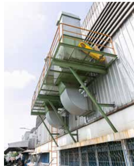
ระบบบำบัดอากาศ Bag House Filter
