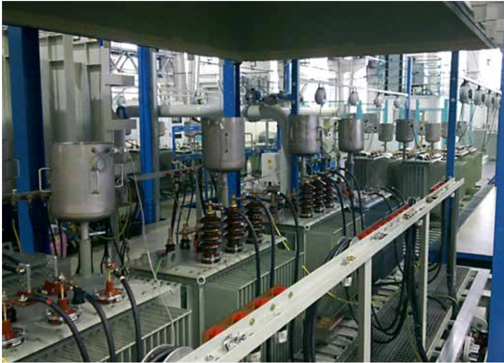
รูปที่ 17 ตัวอย่างการติดตั้งอุปกรณ์วัดค่าต่างๆ และการต่อระบบจ่ายไฟฟ้าความถี่ต่ำเข้ากับหม้อแปลงไฟฟ้า
