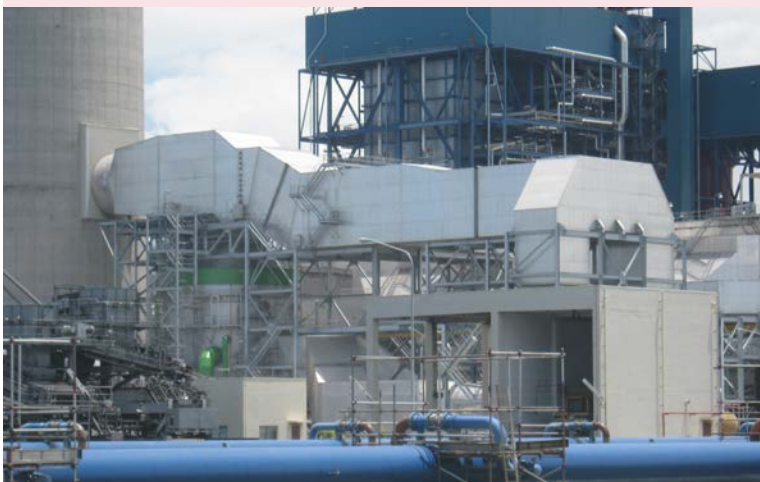
ระบบดักจับก๊าซซัลเฟอร์ไดออกไซด์ (Sea Water FGD)
