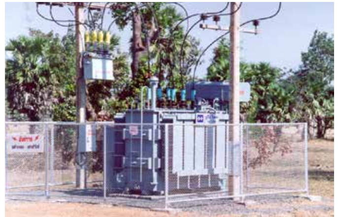
▶ หม้อแปลงไฟฟ้า ชนิด Automatic Voltage Regulator ขนาด 16 MVA 23.1 kV ในระบบสายส่งของ กฟภ.
