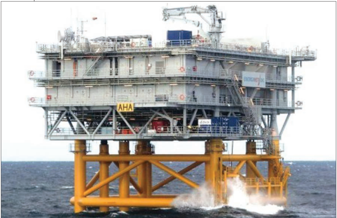
รูปที่ 8 สถานีไฟฟ้านอกชายฝั่ง
