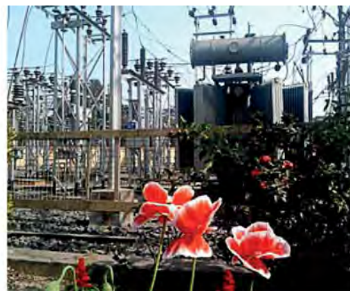
(ข) สถานีไฟฟ้าย่อยแรงดัน 33 kV เมื่อ 20 ปีที่แล้ว
