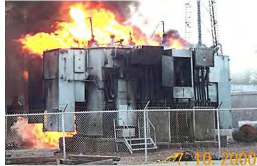
รูปที่ 4 ไฟไหม้หม้อแปลงกำลัง
