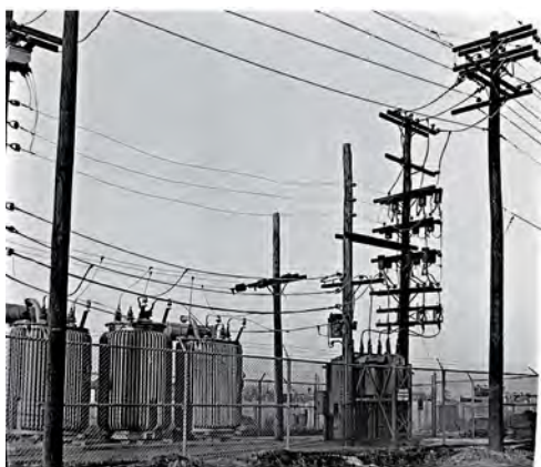
(ก) สถานีไฟฟ้าย่อยแรงดัน 4 kV เมื่อ 50 ปีที่แล้ว
