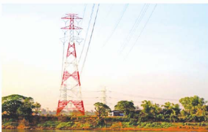
สายส่ง 500 เครวี บ้านนาบง - อุดรธานี 3 ของโครงการน้ำจิม 2 ปี พ.ศ. 2553
