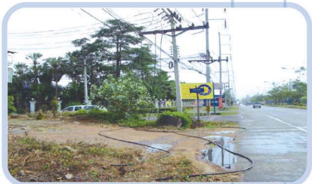
ภาพที่ 2 เหตุการณ์สายจ่ายไฟฟ้าขาด 3 เฟสจากสถานที่จริง
