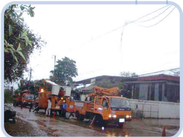
ภาพที่ 3 เหตุการณ์สายจ่ายไฟฟ้าขาด 2 เฟสจากสถานที่จริง
