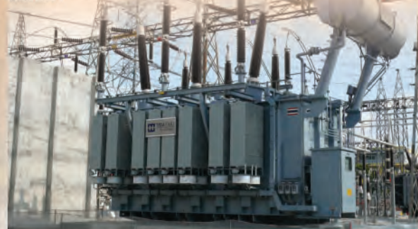
ภาพหม้อแปลงที่ติดตั้งเสร็จเรียบร้อยแล้ว
