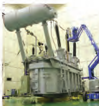
รูปที่ 17 หม้อแปลงกำลังขนาด 300 MVA, 230 kV ขณะทดสอบ
